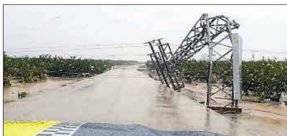
Una instalación eléctrica afectada por el temporal. EP
